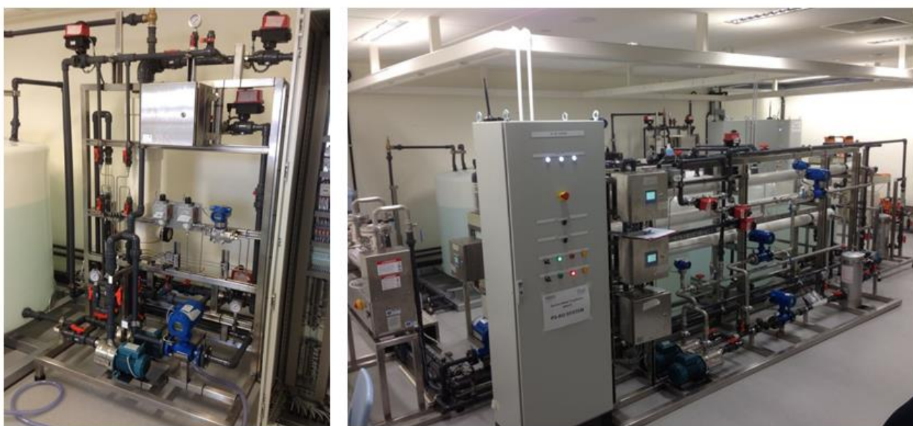
Рисунок 16 – Слева: ультрафильтрация | Справа: общий вид КФС водоочистки
