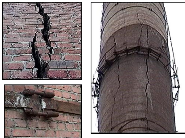
Рисунок 16 – Наблюдаемые дефекты: вертикальные трещины; деформация стяжных колец, разрушение оголовка
