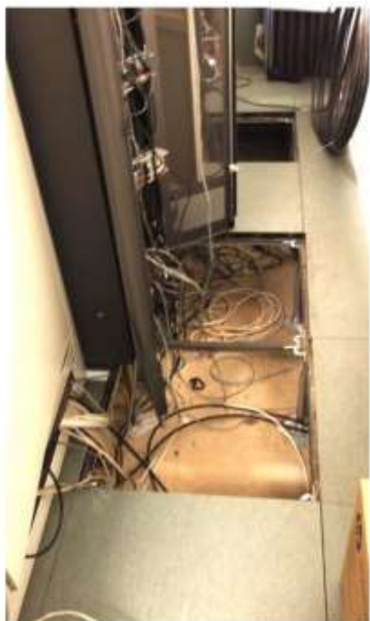
Рисунок 4.11 – Нарушения в серверном помещении на компрессорной станции
