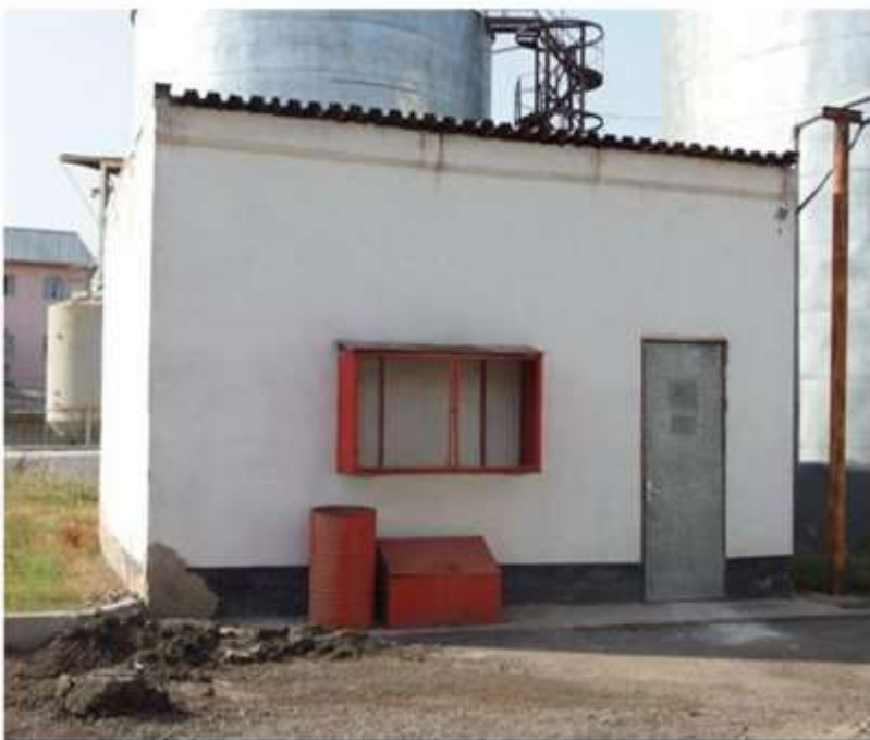
Рисунок 4.12 – Разукомплектованный противопожарный щит насосной станции нефтебазы
